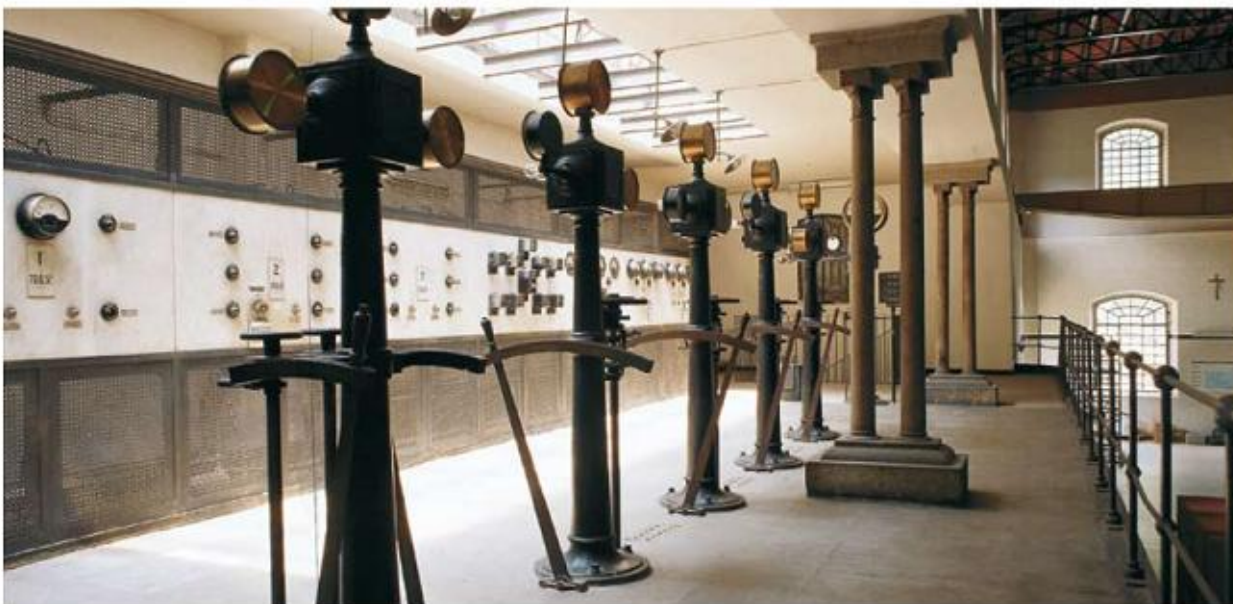
Particolari vecchie apparecchiature
