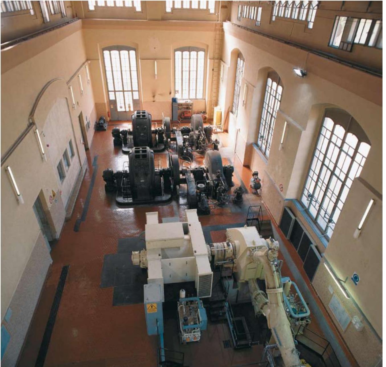
Veduta della sala macchine
