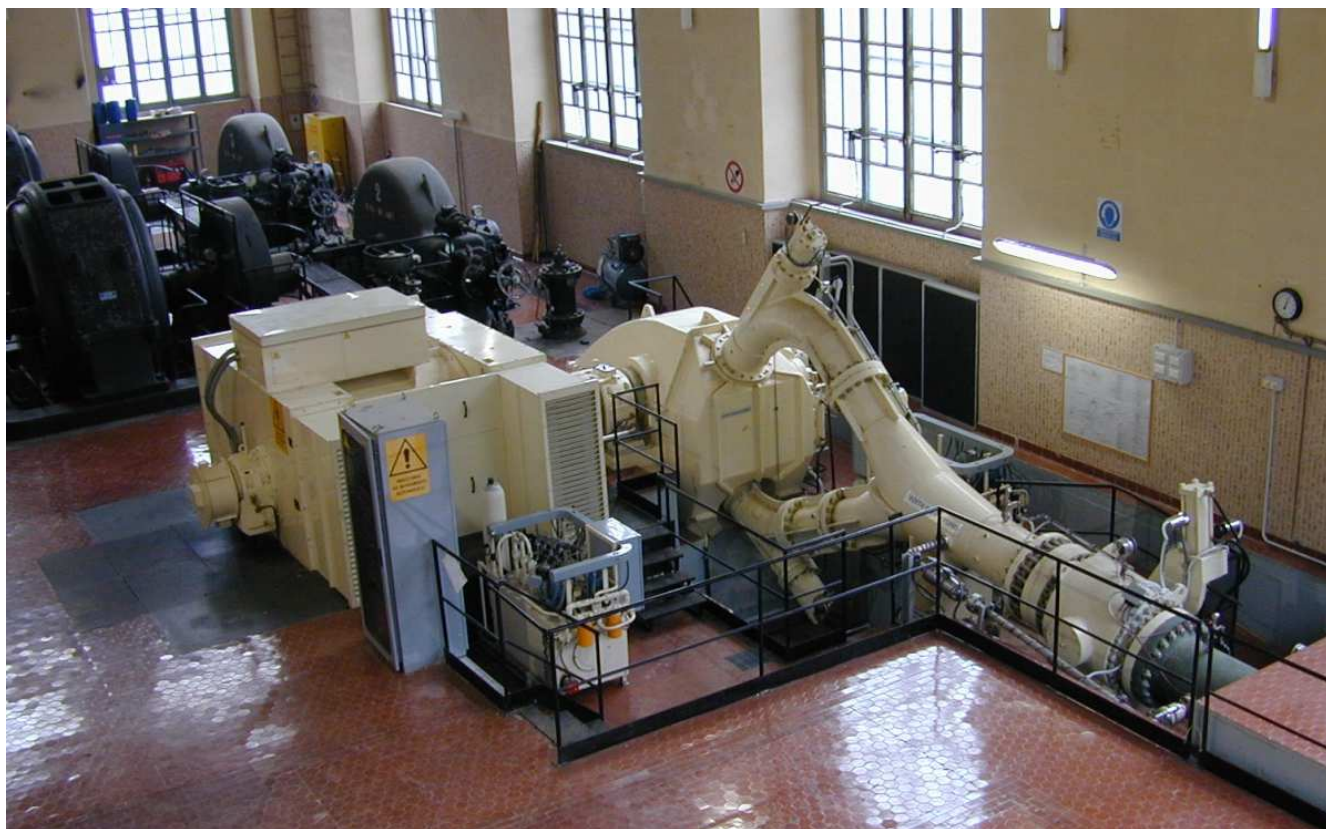
Impianto di Pozzolago, sala macchine
