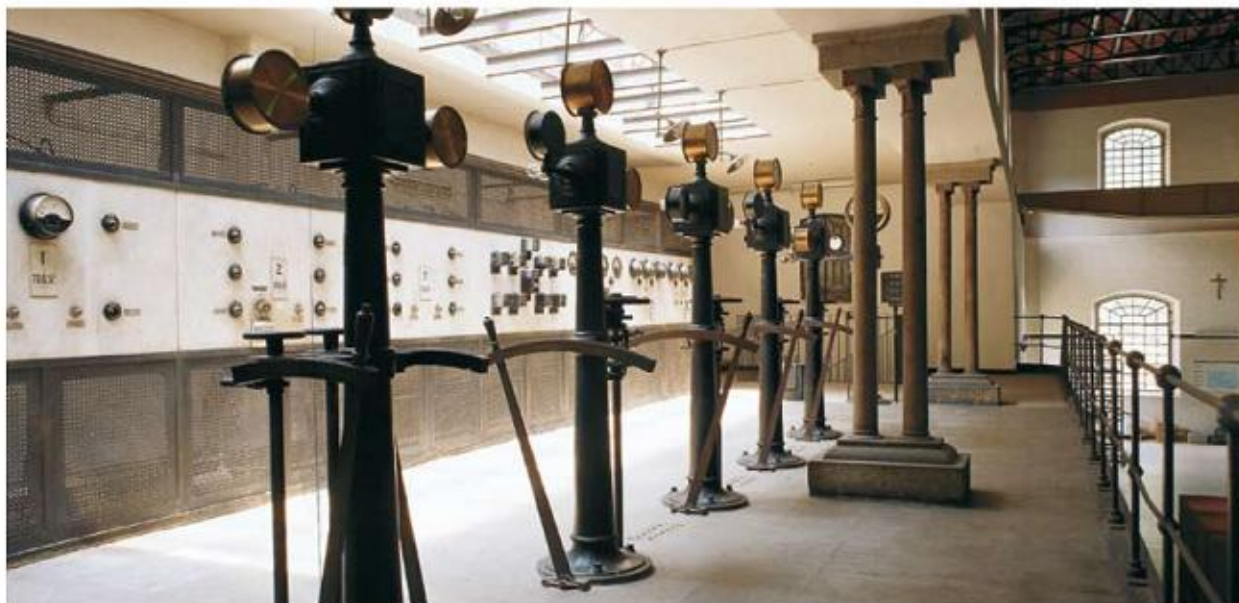
Particolari vecchie apparecchiature
