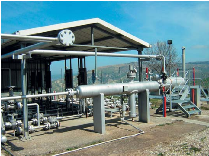
Collettore arrivo dai pozzi (manifold)
