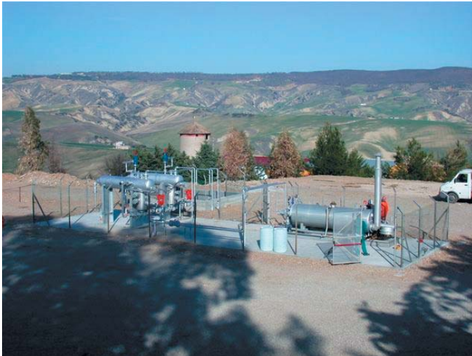
Piazzale pozzo AC4 e impianto di trattamento gas naturale della Centrale di Garaguso
